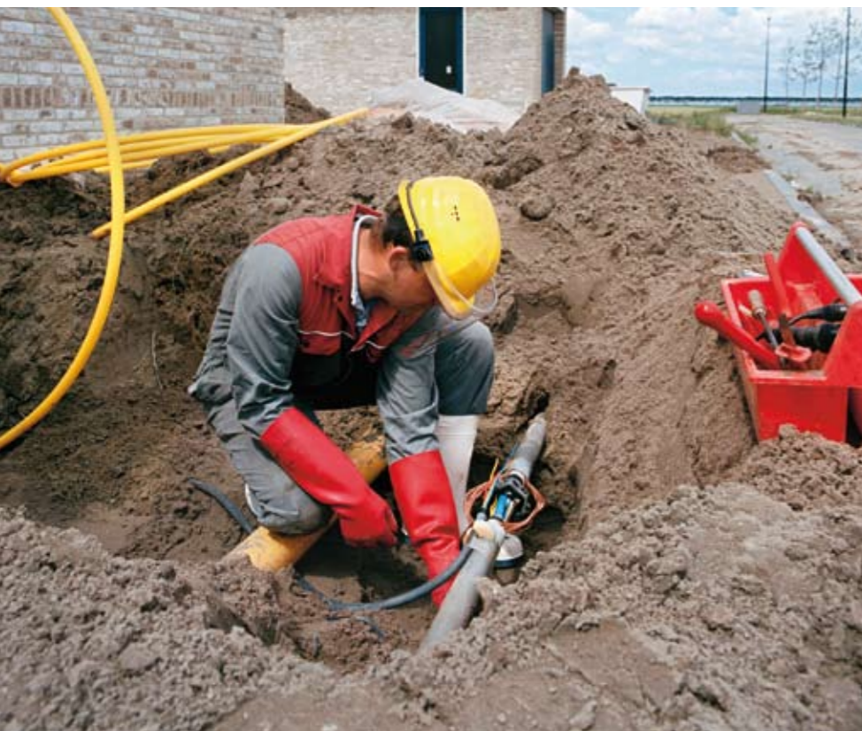
Nicht nur Energielieferant, sondern auch Netzbetreiber: das Leitungsnetz von ENECO versorgt das wirtschaftliche Herz der Niederlande
